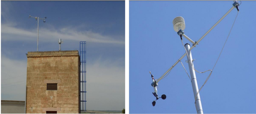
Fig.9 Localizzazione e dettaglio della centralina meteorologica installata in discarica.
